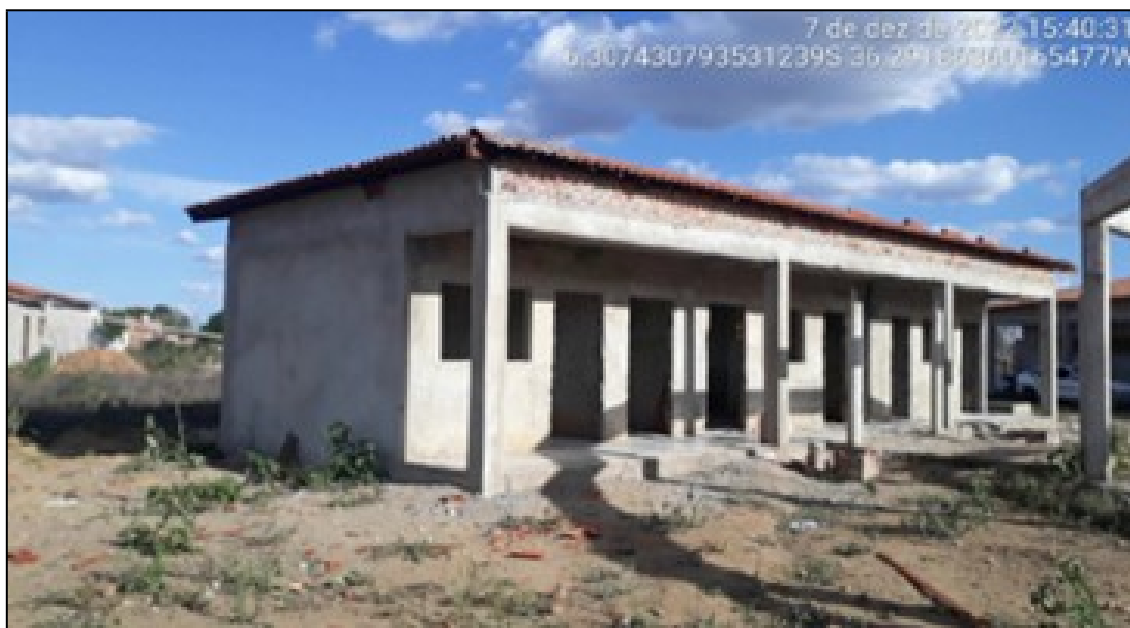
Figura 3 – Escola em zona rural do Município de Picuí/PB: obras paralisadas desde 2018.
