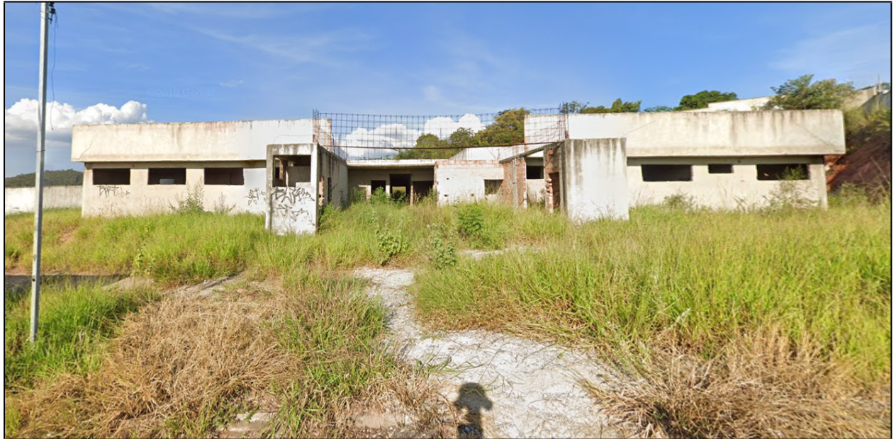
Figura 6 – UBS em Ribeirão das Neves/MG. Obra paralisada em 2015.
