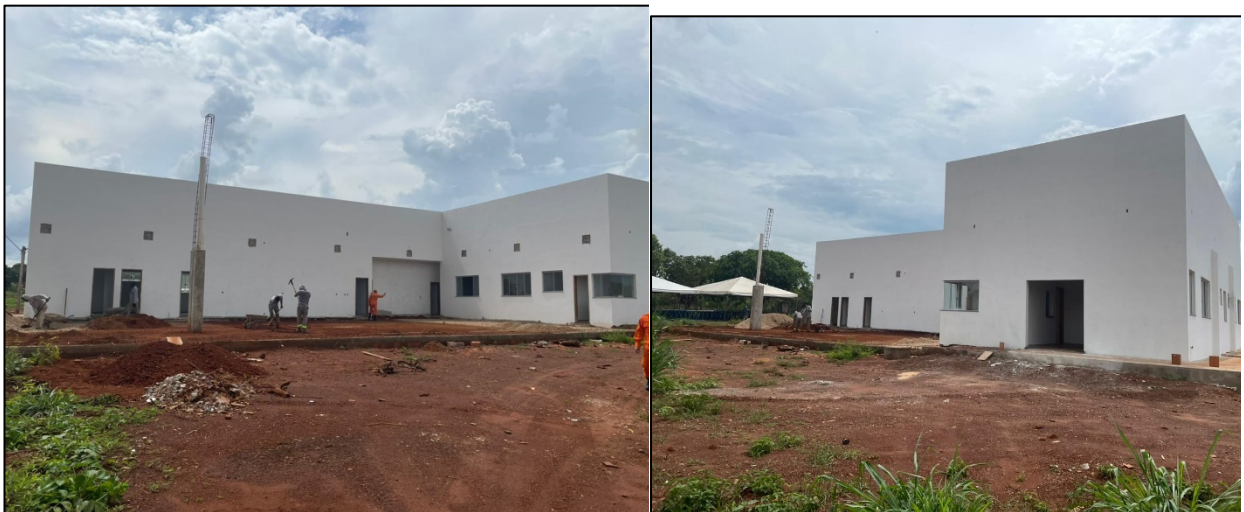
Construção do Quartel da 5ª Cia / 1º BBM do CBMTO de Porto Nacional (foto de 02/12/2022).
