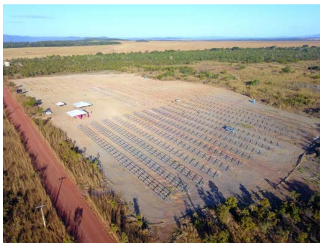
Instalação do pátio de geração de energia fotovoltaica do Projeto São João.
